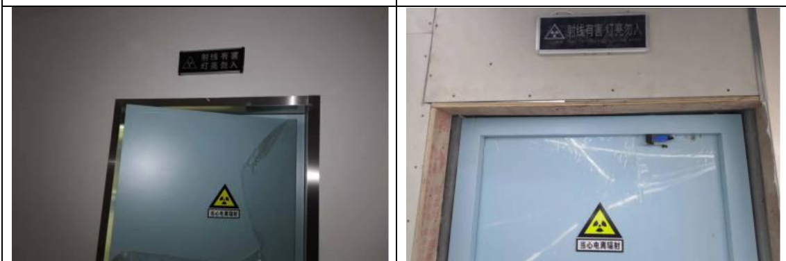
警告标志等辐射防护设施
